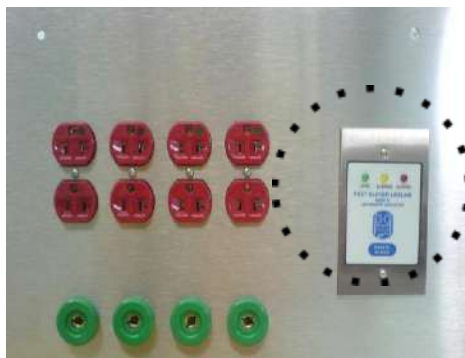
Fig. 12 Alarma remota en módulo de receptáculos
